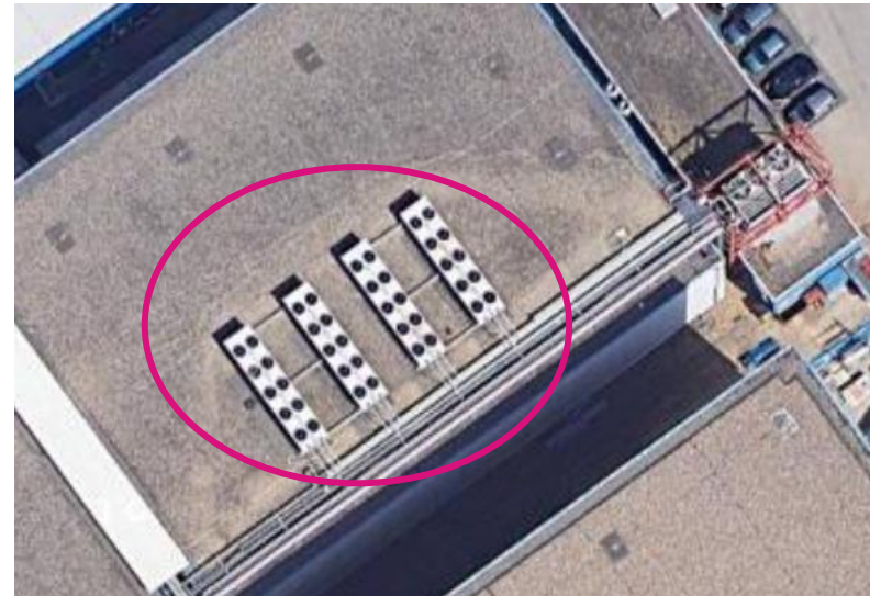
Afbeelding 9 – Voorbeeld condensoren op dak bedrijf
